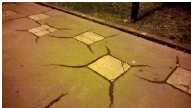
Obr. 15 Viskoelastické chování materiálu. Studený tok (creep) asfaltu na cestě je omezen betonovými, tuhými deskami. Dochází ke vzniku prasklin na hranách působením reziduálních napětí.
