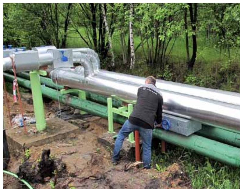
Odvzdušňování nadzemní části tepelného napáječe
