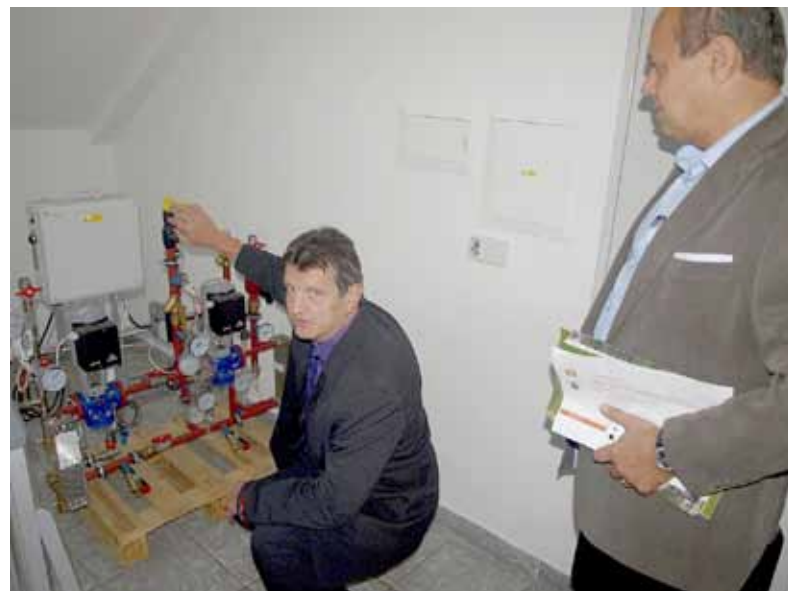
Manažer provozní jednotky ČEZ Teplárenská v Bílině Petr Smrž seznamuje zájemce s technologií objektové předávací stanice
