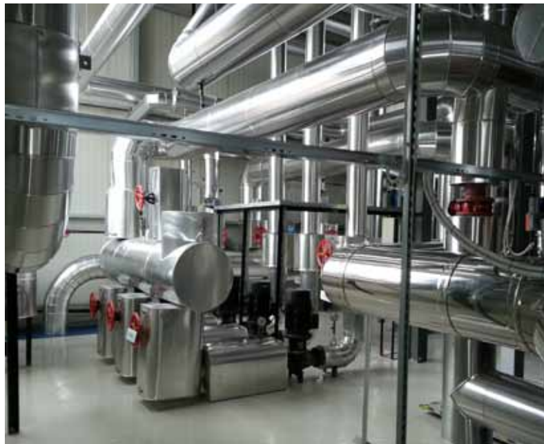
Pohled na technologii kotelny
