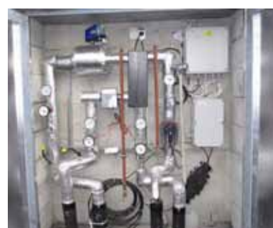
Kompaktní předávací stanice v přístřešku v ulici Polní mez s přípravou ÚT pro podlahové vytápění
