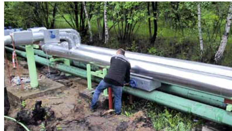
Odvzdušňování nadzemní části tepelného napaječe
