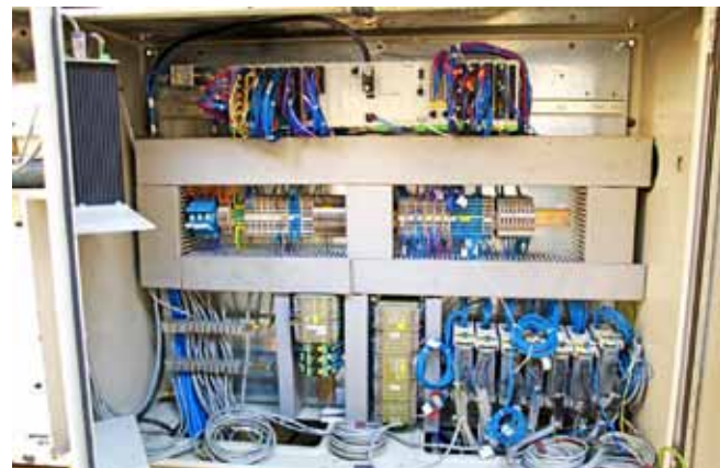
Rekonstruovaný rozvaděč s řízením KEBA
