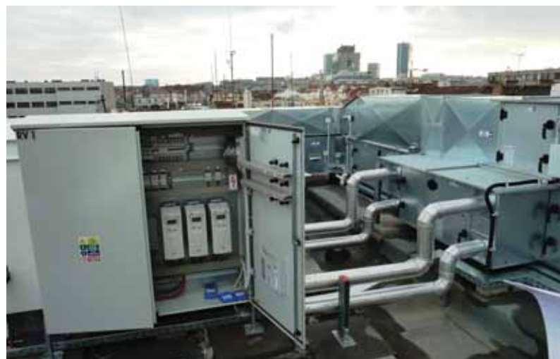
Obr. 2: Měniče frekvence ACH550 nainstalované v budově Qubix
