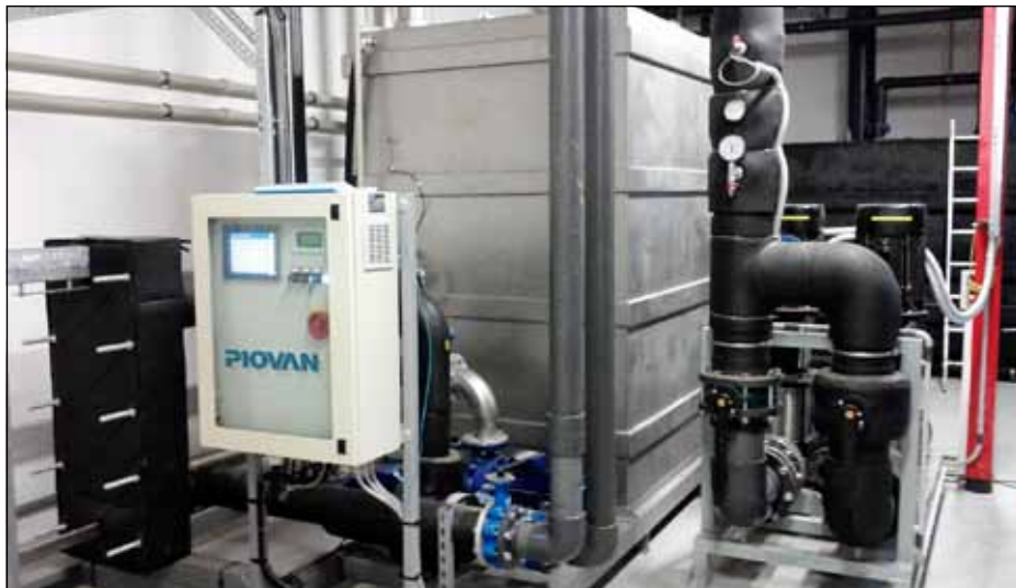
Firma Greiner Assistec dosáhla s novým chladicím zařízením, které uvedla do provozu na sklonku roku 2011, snížení spotřeby energie o 693 857 kWh ročně
