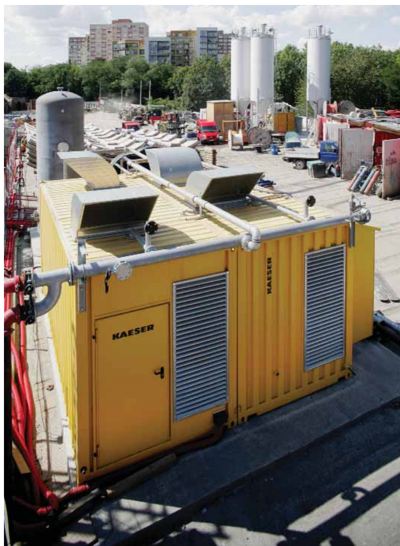
Kompresorová stanice stlačeného vzduchu KAESER KOMPRESSOREN
