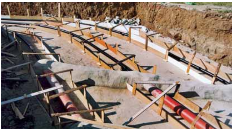
Jednoduché kabelové vedení 400 kV v rozvodně
