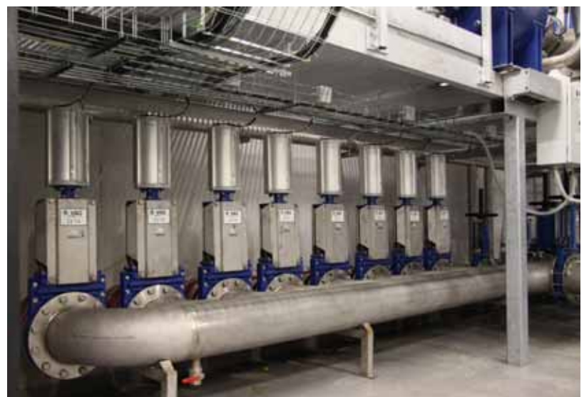
Baterie šoupat v podzemí
